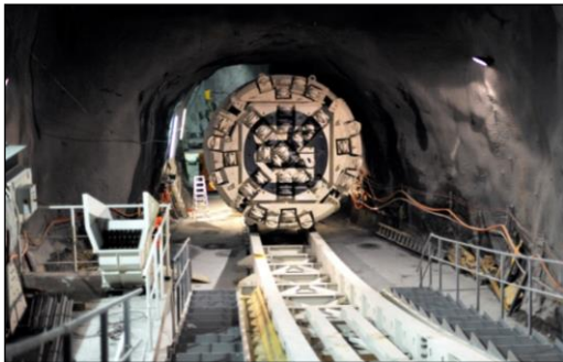
TBM Druckschächte (Ø = 5.20 m, L= 1054 m)
