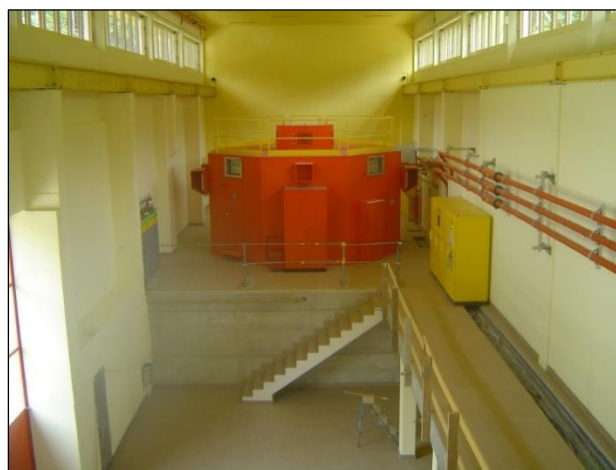
Vista interna della centrale, Niedererbach gruppo macchine
