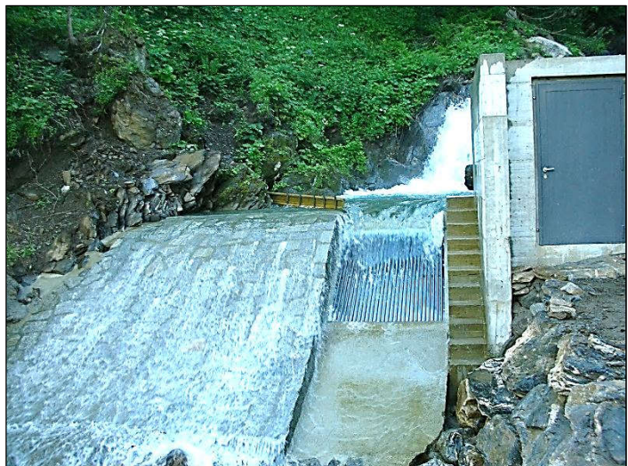
Sbarramento fisso con la captazione tipo Tirolese
