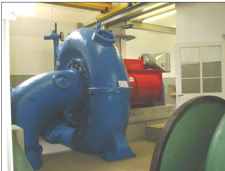
Turbina Francis rinnovata con il generatore accoppiato direttamente
