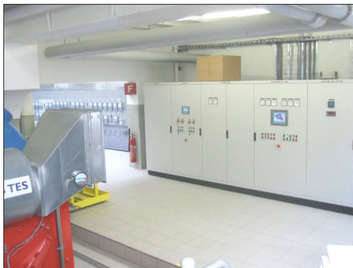
Armadi di comando della centrale
