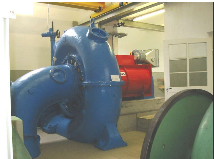
Erneuerte Francisturbine mit direkt gekoppelten Generator
