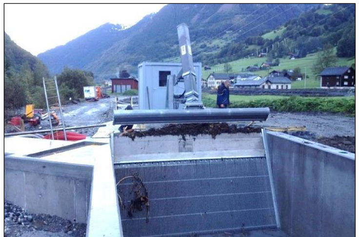
Rechenreinigungsmaschine am Ende des Entsanders
