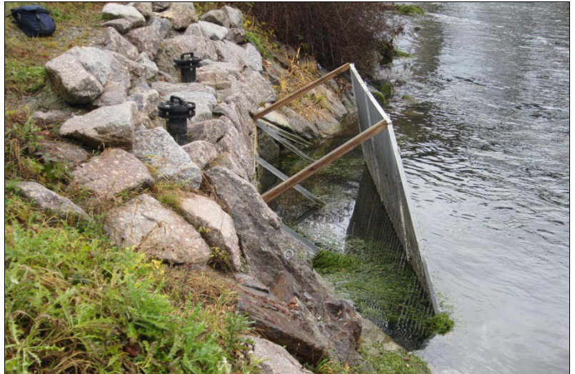
Ausgangszustand der Wasserfassung mit starker Verschmutzung durch Wasserpflanzen
