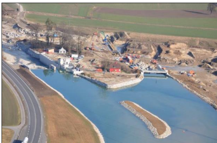
Panoramica KW Ettisbühl con centrale elettrica e bacino di ritenzione del legname
