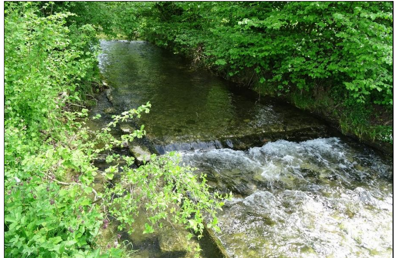
Ausgangszustand mit sanierungsbedürftiger Schwelle
