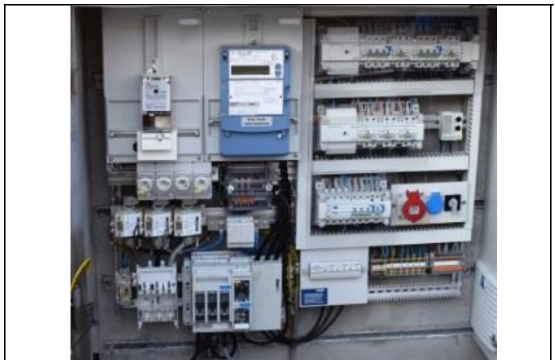
UV und Steuerung – PW General Wille Strasse
