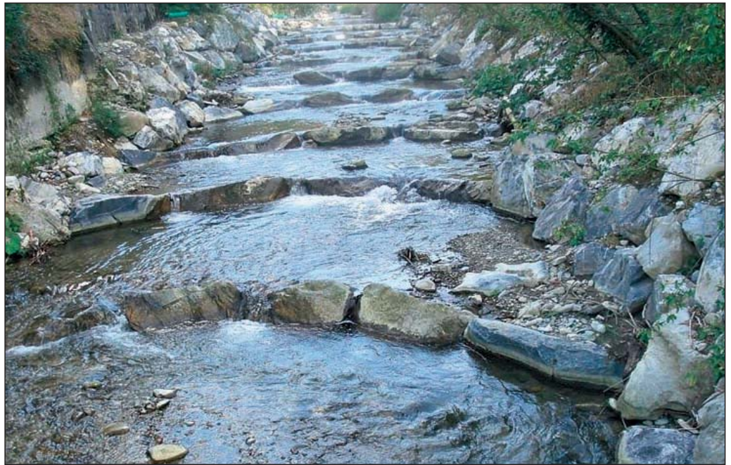
Foto 3: Optimierte neue Pendelrampe mit bogenförmigen, in der Böschung verankerten Riegeln im September 2009.
