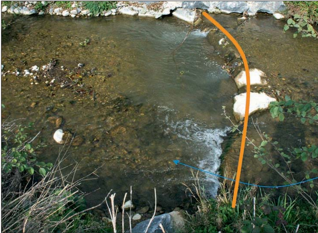
Foto 1: Bogenförmiger linksseitig vertiefter Riegel mit anschliessender Kolkbildung und Ablagerungen. Photo 1: Traverse en forme d'arc enfoncée du côté gauche avec affouillement consécutif et formation de dépôts.
