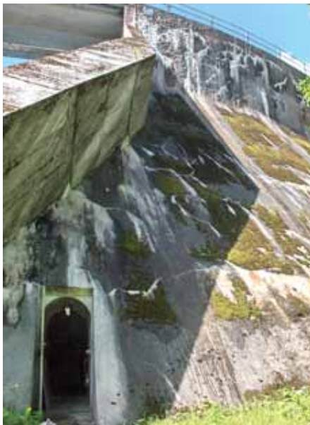
Bild 5. Oberflächenschäden, Staumauer Egschi.
