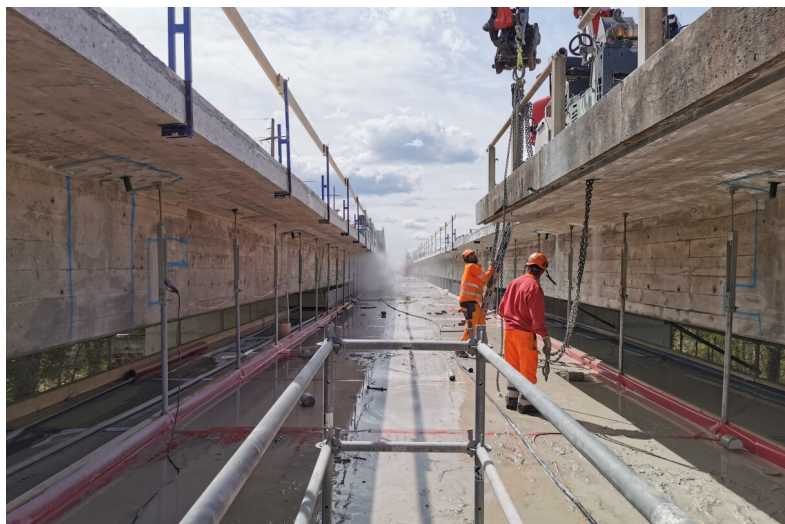
Demolizione spartitraffico prima di un ampliamento necessario per la gestione del traffico
