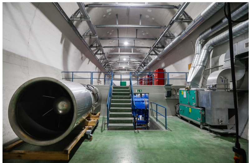
Lüftungszentrale San Bernardino Tunnel
