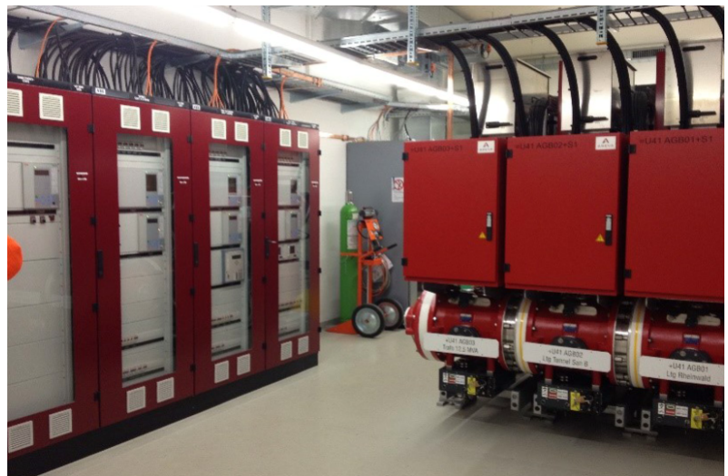
Mittelspannungsräume San Bernardino Tunnel
